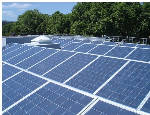
Dach mit neuer Photovoltaik Anlage
